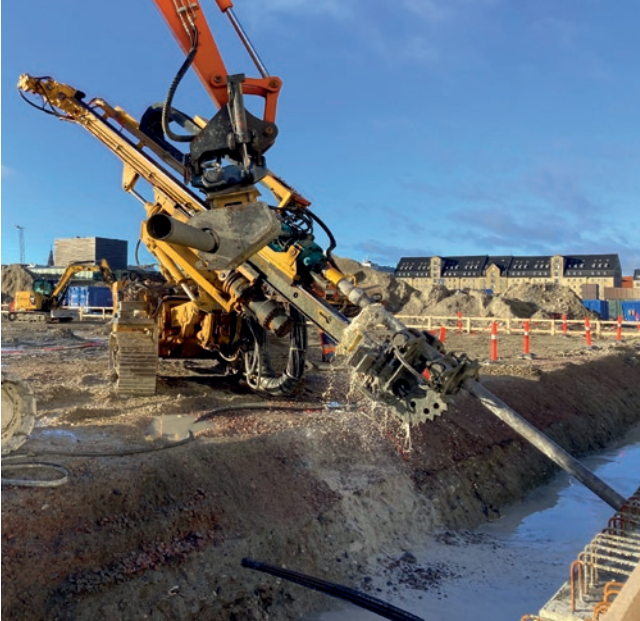
Operaparken, Kopenhagen, Dänemark Rückverankerung einer Schlitzwand in zwei Ankerlagen mit insgesamt 186 Litzenkurzzeitankern.
