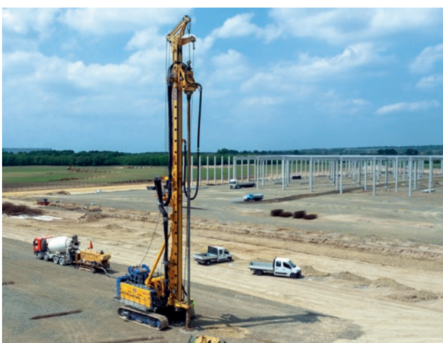
Neubau Logistikhallen, Maglód, Ungarn Herstellung von Gründungspfählen mit einem Durchmesser von 360 mm mittels FDP-Verfahren.
