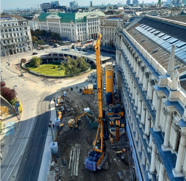
U-Bahn-Linienkreuz, Wien, Österreich Herstellung von ca. 35.000 m Bohrpfählen mit verschiedenen Durchmessern von bis zu 1.180 mm und Bohrtiefen von bis zu 61 m.
