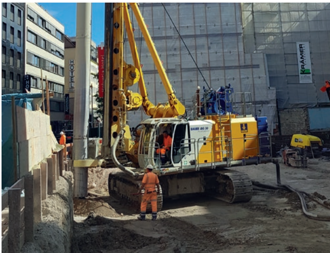
Neubau Bürogebäude, München, Deutschland Ausführung einer überschnittenen Bohrpfahlwand mit einem Durchmesser von 620 mm und 18 m Tiefe mittels VdW-Verfahren.
