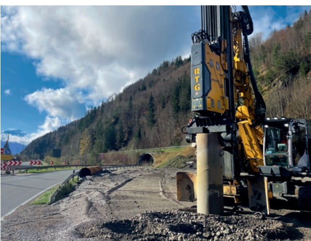
Neubau B2, Eschenlohe, Deutschland Für die neue Ortsumfahrung B2 wurden insgesamt 6.200 m Rütteltextilsäulen hergestellt.
