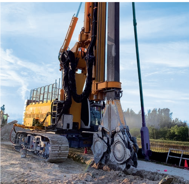
Herbert Hoover Dike, Florida, USA Zur Verbesserung der Dammsicherheit wurden 28,3 km Dichtwand mit einer Tiefe bis zu 20 m installiert.
