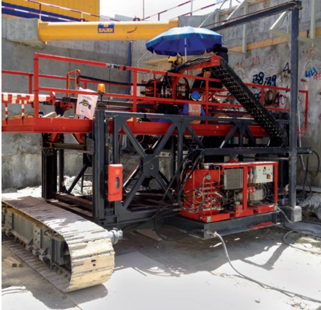
Fußgängertunnel, Doha, Katar Gesteuerte Bohrungen für die Abdichtungs- und Stabilisierungsinjektion eines Fußgängertunnels von 90 m.
